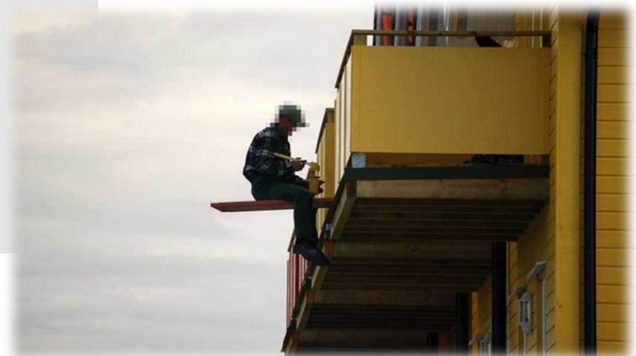
Usikret arbeid i høyden
